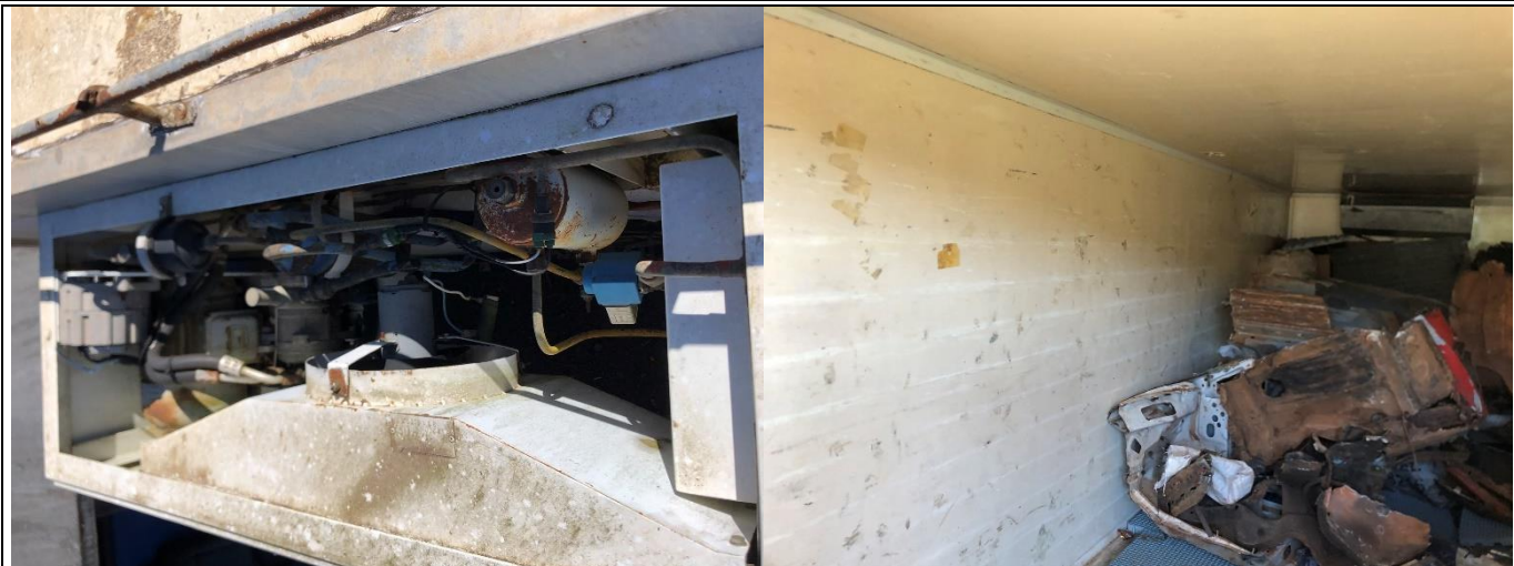
Figura 7- Unidade de refrigeração
