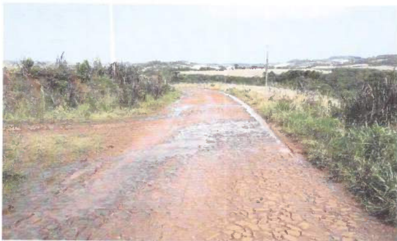
Figura 8: TRECHO 03, pt 21 GPS (necessidade de bueiros laterais). TRÁS
