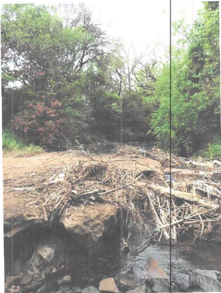
Imagem 12: Restos de concreto no encontro da Rua Tancredo Neves com o Rio Aurora
