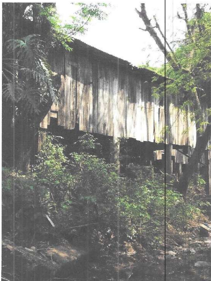
Imagem 08: Edificação no leito do Rio Cedro
